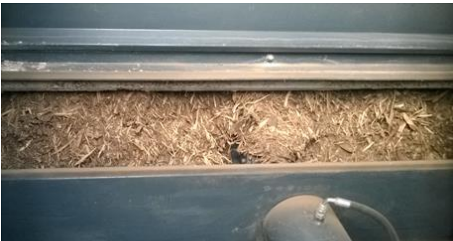
Kuva 2. Popolin hakelämpölaitoksen haketta. Hakkeen laatu ei ollut kohteessa kovin hyvä.
