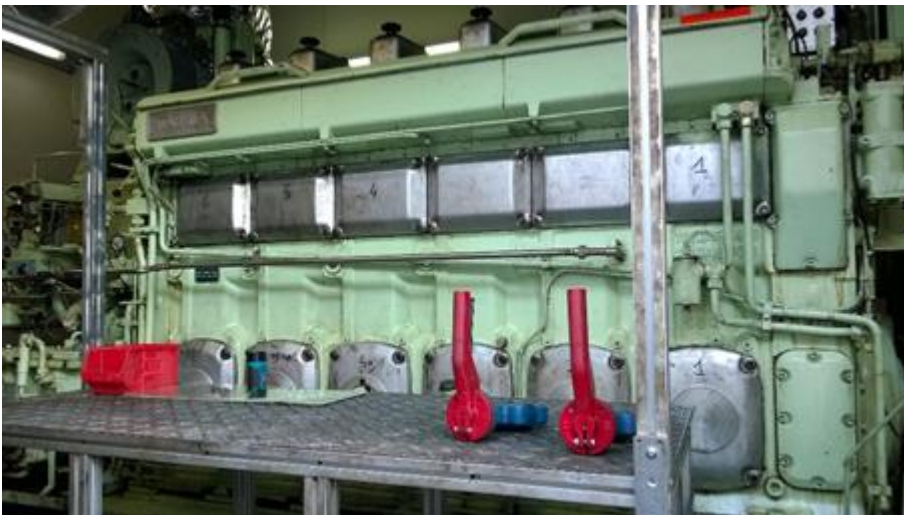
Kuva 1. Kasviöljyä polttoaineena käyttävä Wärtsilä-merkkinen CHP-laitos Vallemaressa.
