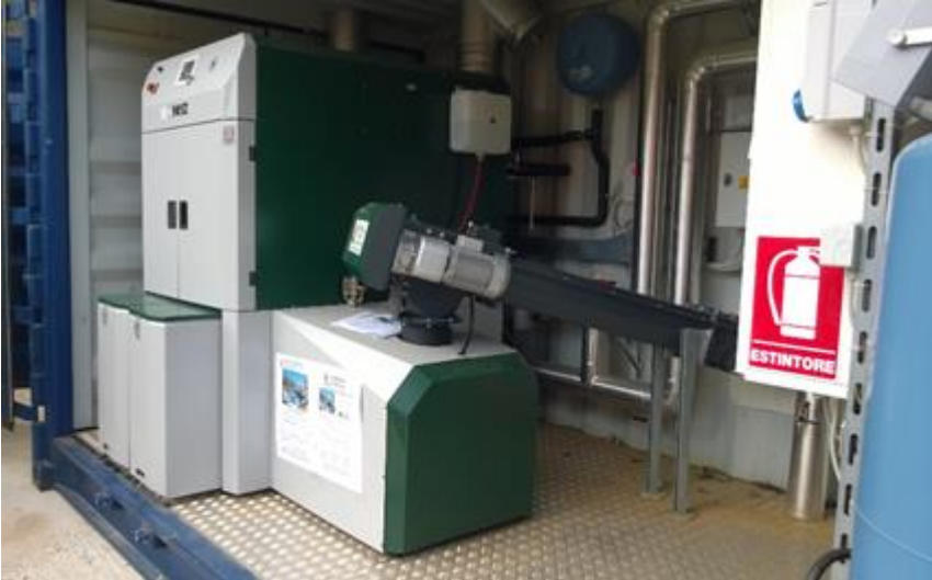
Kuva 5. Condotta Forestalen hakekattila. Hake siirretään seinän takana olevasta varastosta ruuvilla kattilalle.
